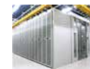
上海鼎奕数据中心
