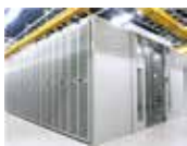
上海鼎奕数据中心
